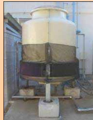
循環水のクーリングタワー
